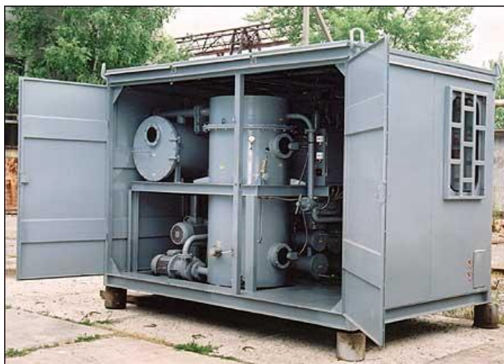
Установка ЭТМА УВМ-5 У1
